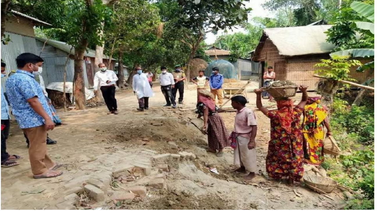
চিত্রঃ ১৮ জনাব জাহিদুর রহমান, উপজেলা নির্বাহী অফিসার, নকলা কর্তৃক শেরপুর জেলাধীন নকলা উপজেলার, নকলা ইউনিয়নের দক্ষিণ নকলা গ্রামের কাবিখা প্রকল্প পরিদর্শন।
